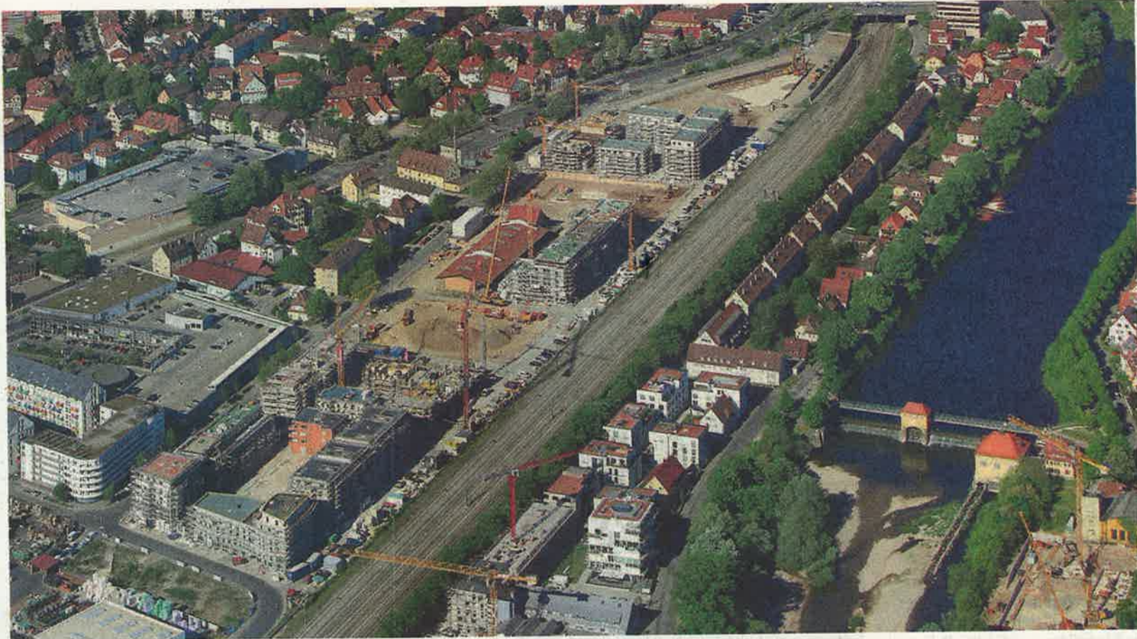
Das Güterbahnhofsgelände: An manchen Stellen steht noch der Aushub an, an anderen sind die ersten Bewohner eingezogen. Zu sehen ist von oben an der Blauen Brücke entlang der Gleise bis zu Kemmler links unten: ein trapezförmiger Platz, der Aushub für den Kopfbau, die noch freie Fläche für einen Wohnungskomplex, Hof 1 mit Gebäude im Rohbau, eine Fläche für Hof 2, Hof 3 mit der alten Güterhalle, eine Fläche für Hof 4, Hof 5 mit Gebäuden im Rohbau, Hof 6 mit dem ersten fertigen und bewohnten Gebäude (In roter Farbe), zwischen Hof 6 und Kemmler eine Freifläche für Gewerbebauten. Bild: Grohe
